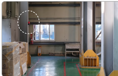
▶ 공장 내 벽면 또는 모서리 구역 / 경광등 ZT
