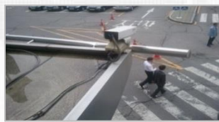
1단계 : 장애발생 일반 고정식 CCTV
