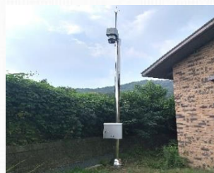
1단계 : 장애발생 오토리프트 CCTV
