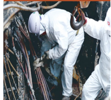
공동구 케이블 화재로 전소
